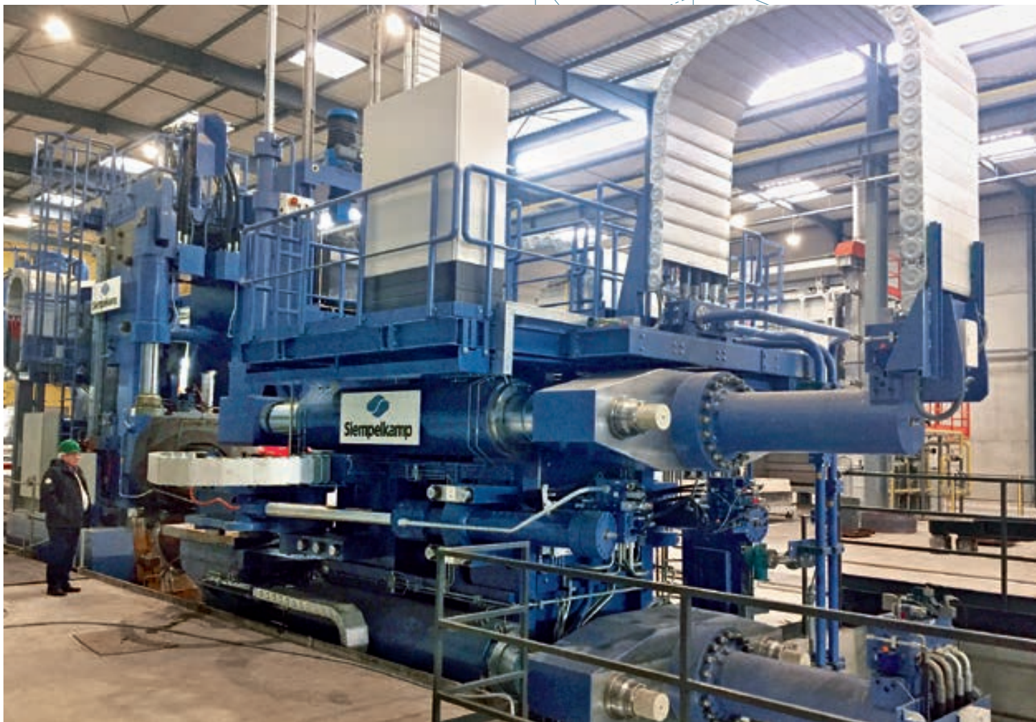
The new ring rolling mill at L'Union des Forgerons
